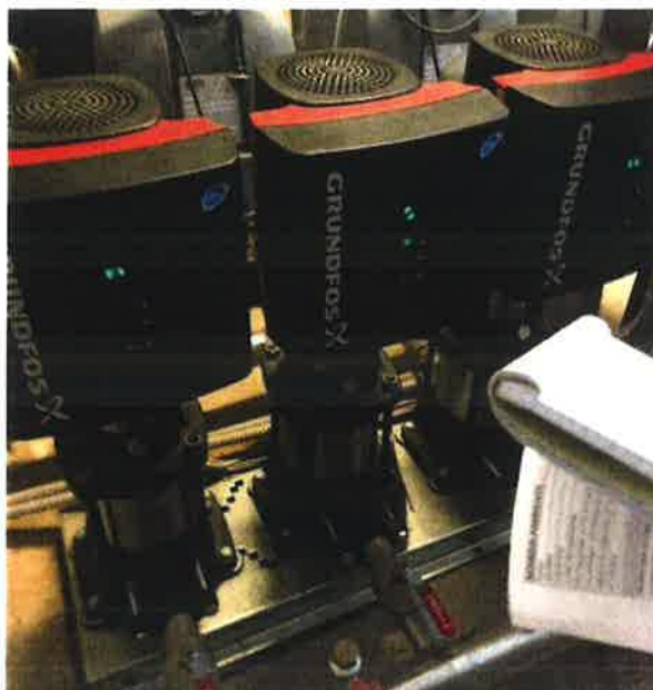
Figura 15 – Pompe all'interno del locale autoclave
