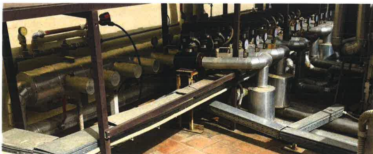
Figura 14 – Pompe di circolazione e rilancio degli impianti di climatizzazione
